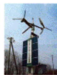
リポート・サービス北海道釧路支店内の設置例：リポート・サービス北海道釧路支店より
