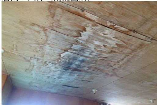
居間の天井 (雨漏箇所)
