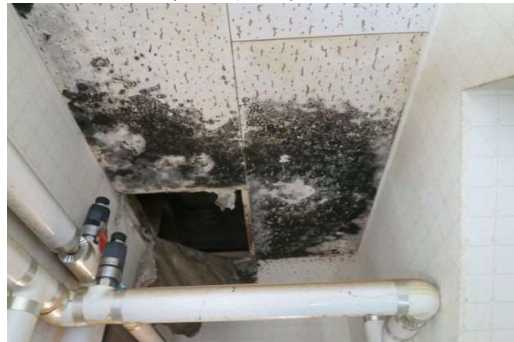
脱衣所天井（雨漏箇所）
