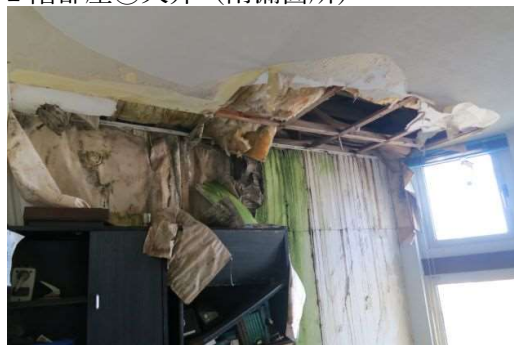
2階部屋①天井（雨漏箇所）
