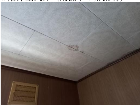
1階洋室天井（雨漏りの形跡有）
