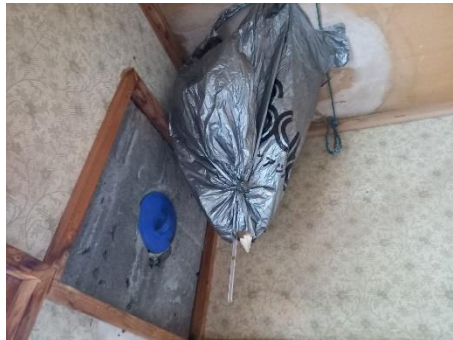
雨漏りの形跡有（2階和室天井）
