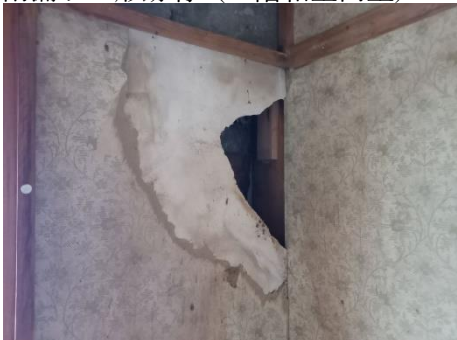
雨漏りの形跡有（2階和室内壁）
