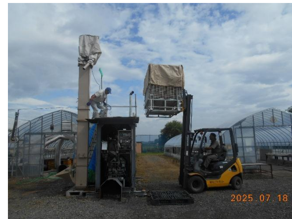
昇降機によるもみ殻の燃料供給
